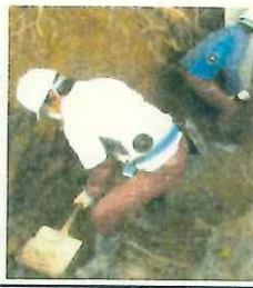
空調機能付きの作業服を活用
